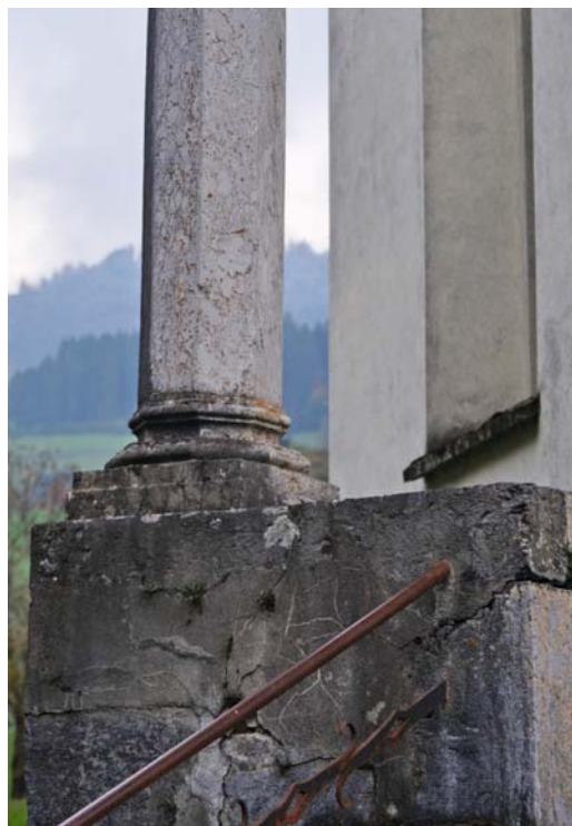
Die Säulen müssen saniert werden.
