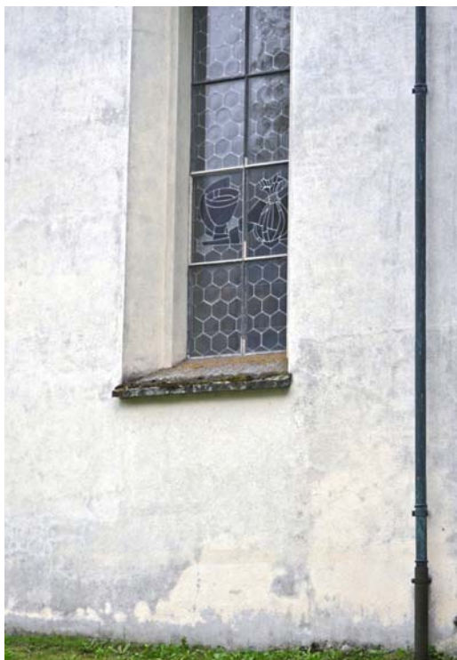
Die Aussenfassade weist starke Schäden auf.
