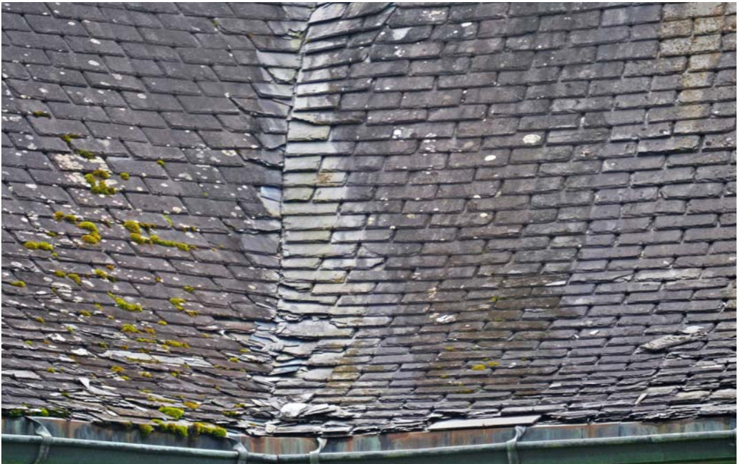
Das Schieferdach ist stark beschädigt und muss dringend erneuert werden.
